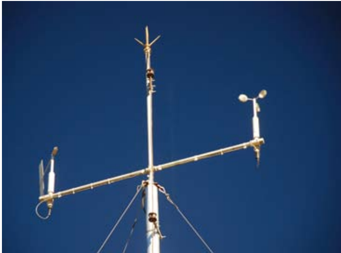
"Estaciones meteorológicas", sensor de viento "Meteorological Stations", wind sensor
